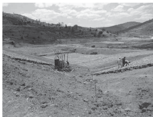
図-2 Ngoma 郡ダムサイト
